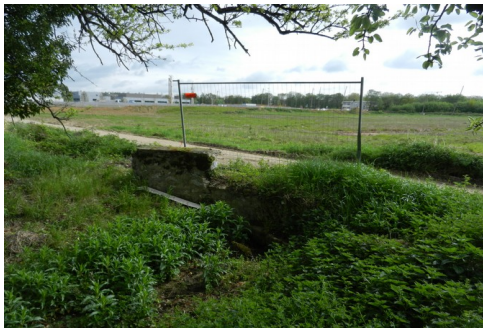
Ponceau sur la rigole vu du côté ouest (On voit à gauche le parapet ouest détérioré)
