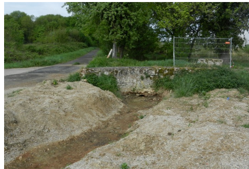
Ponceau sur la rigole vu du côté est (Ecoulement des eaux bloqué par des dépôts volontaires)
